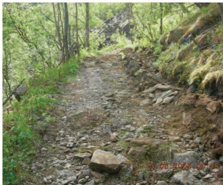
Før: Store utfordringer med erosjon og steinblokker som hadde rast ned i veien.
